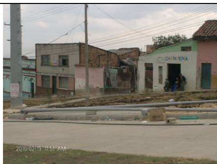
FOTO 6 A lo largo de la Av. Comuneros se encuentran botados los postes que faltan por instalar.
