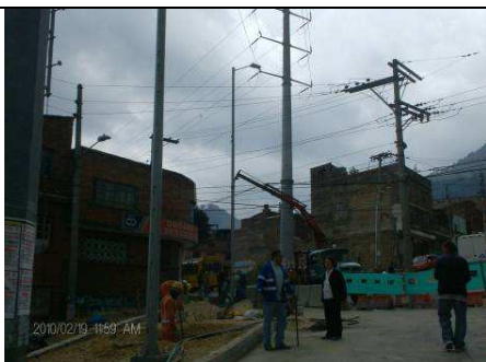
FOTO 5 Empalme de la Av. Comuneros con la Av. Circunvalar. Las empresas de servicios están desvistiendo los postes. El personal de la obra se encuentra instalando tubería y cableado
