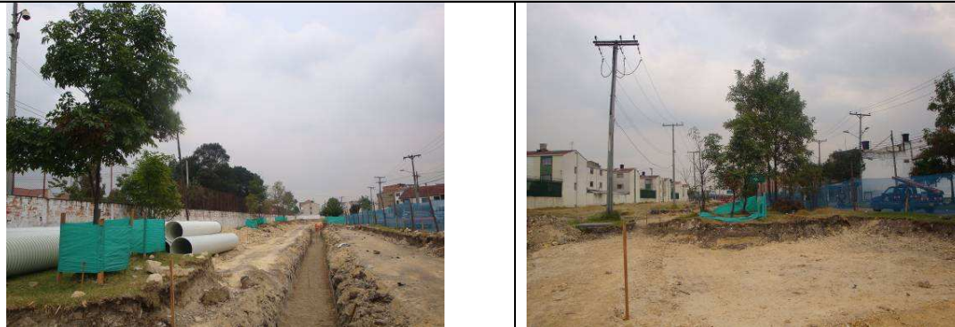
Visita Fiscal 23 de febrero de 2010 Problemas de árboles en la vía por falta del concepto ambiental
