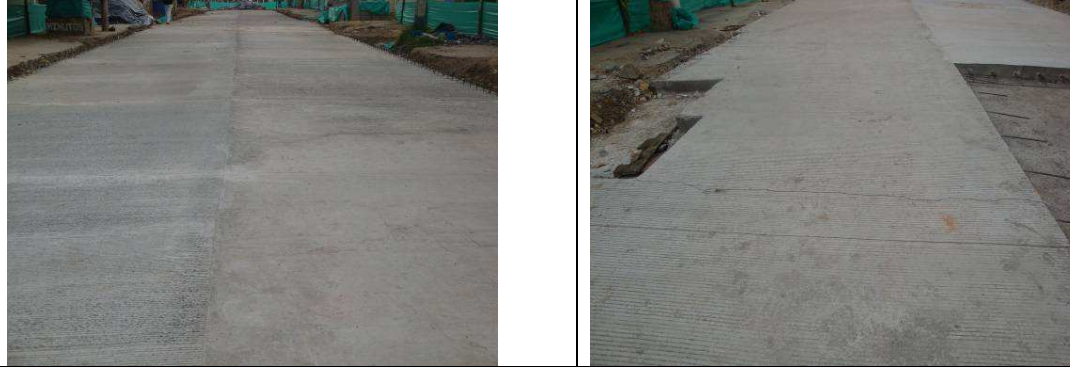
Visita Fiscal 23 de febrero de 2010 – Falta espacio público, sumideros, sardineles Acabado de placas es deficiente – Presenta placa fisurada
